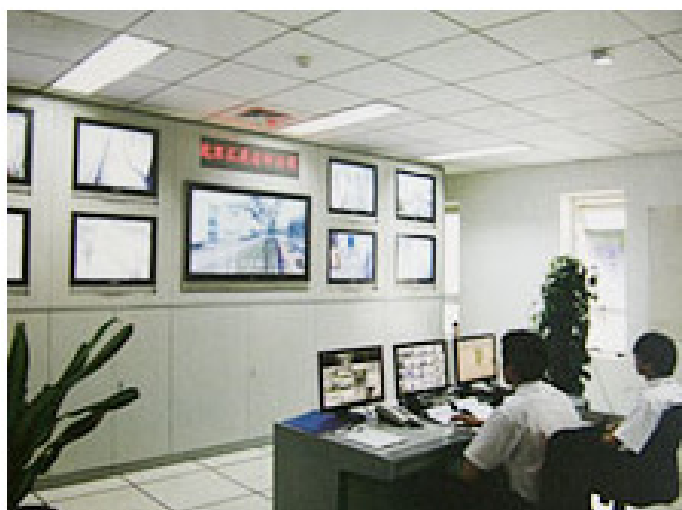
図表 4-26 汇晨養老集団の無線システム制御室
