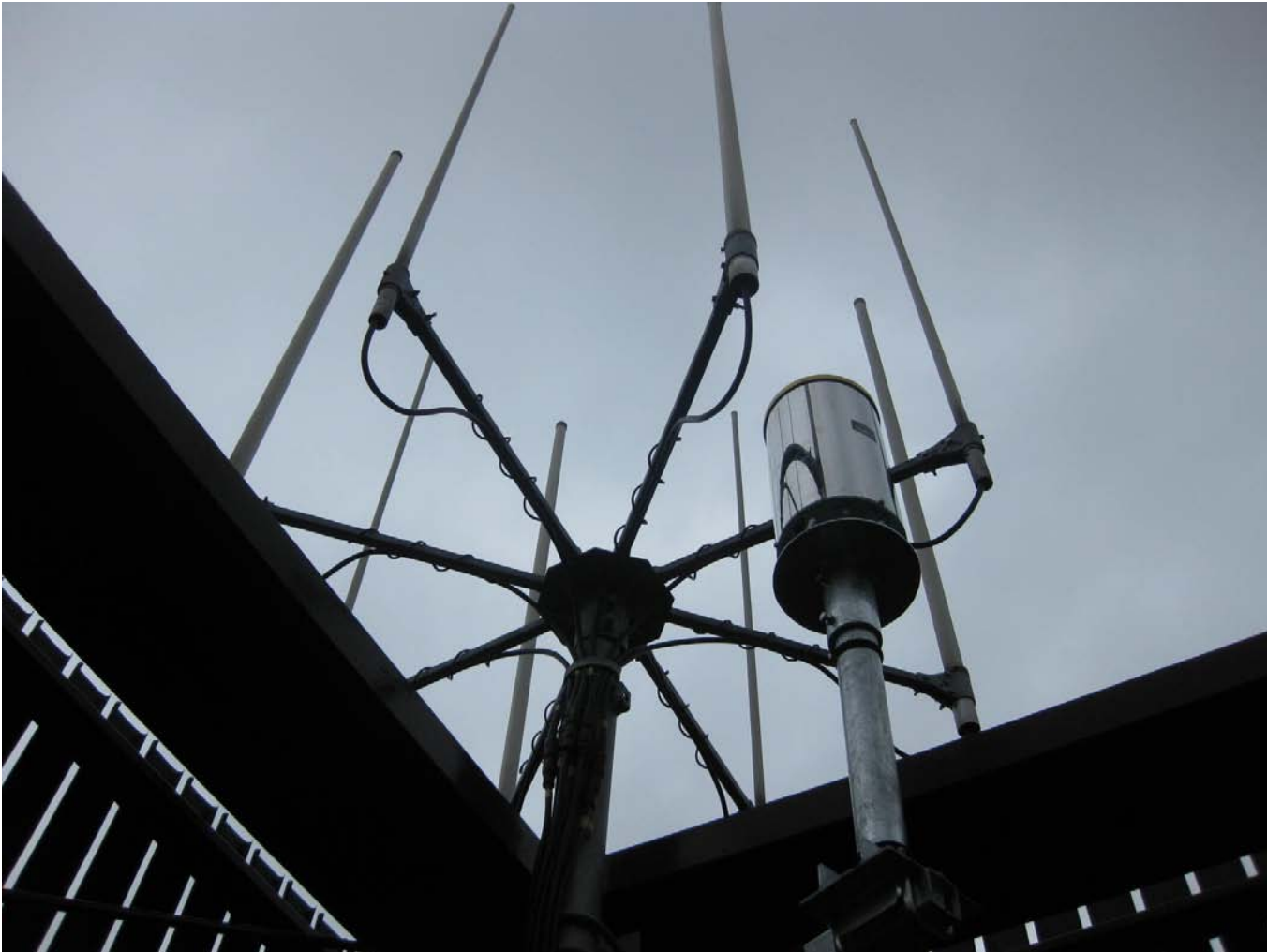
ウィルコム本社屋上に設置
