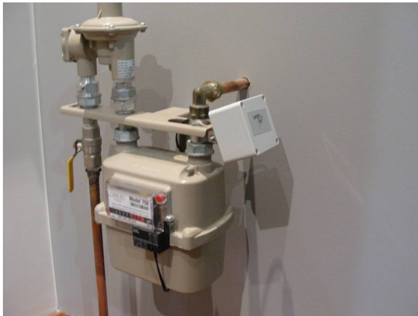
ガスメーター
