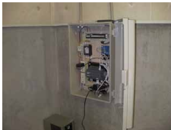
写真 : エネルギーマネジメント盤
