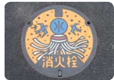
地下に埋設された消火栓の例
