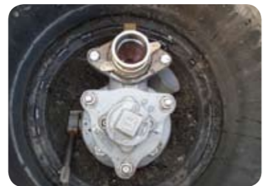
地下に埋設された消火栓の内部
