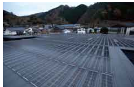
▼梶原町総合庁舎の屋上に取り付けられた80kWの太陽光発電パネル。
