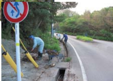
道路沿いの草刈りや枯れ葉の清掃を、地域住民によるボランティアが行っている。
