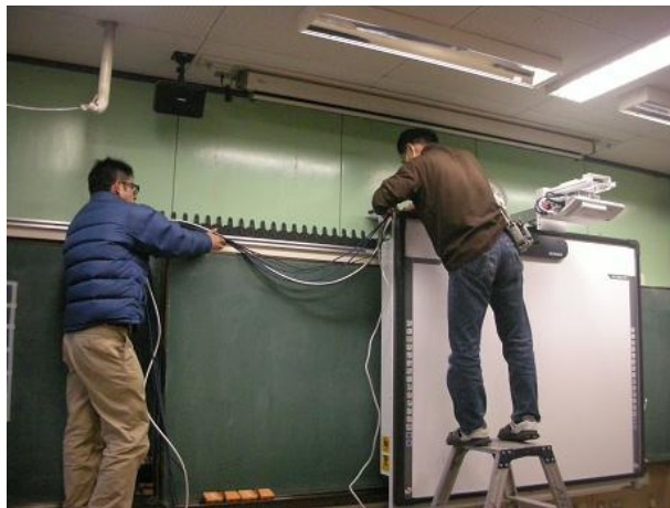
電子黒板設置
