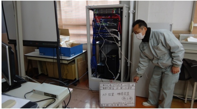
無線コントローラ・共通サーバ設置
