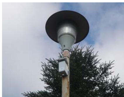
公園照明に設置
