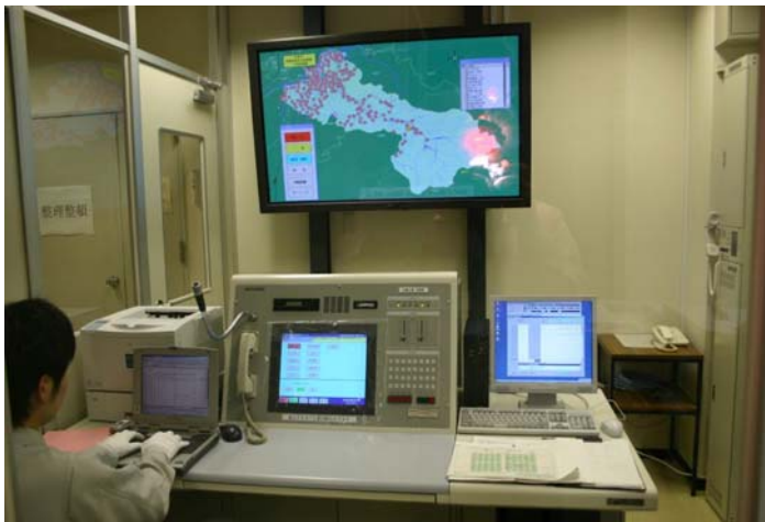
防災無線の制御卓
