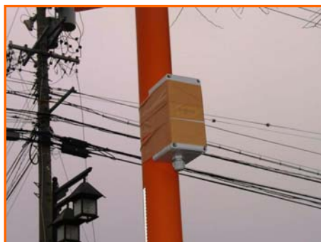
カーブミラーに臨時に設置した中継機
