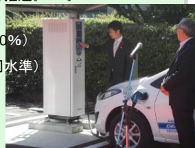
急速充電器の設置
