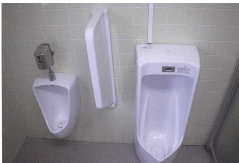
(改善後) 高齢者、障がい者 等が利用しやすい床 置き式小便器を設置
