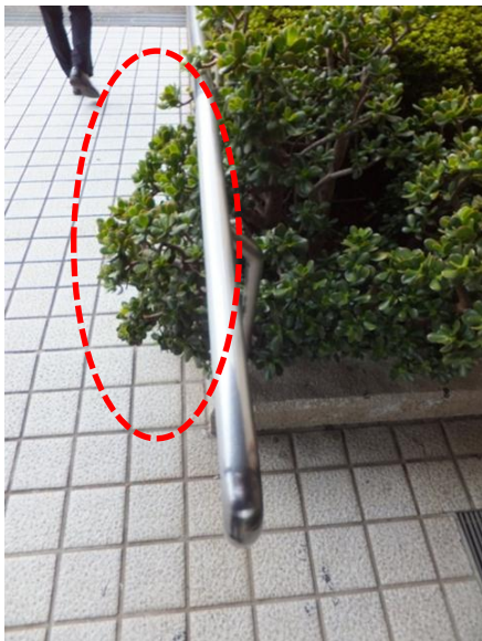
(改善前) 植栽が傾斜路の手すりから約 20 センチメートル突出
