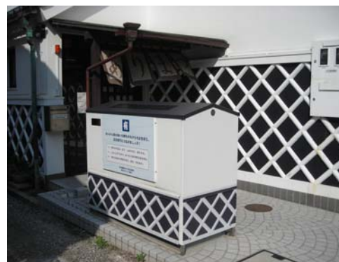
(注) 町並み景観に合うよう地上機器もカムフラージュする工夫が施されている。
