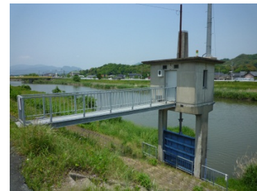
洪水から暮らしを守る河川管理施設・許可工作物（写真は樋管）
