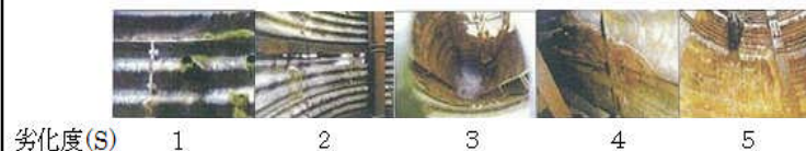
集水井の劣化度評価
