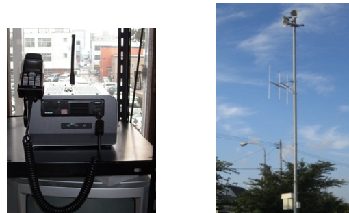
デジタル防災行政無線設備
