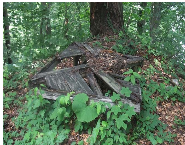
⑦ 倒壊した東屋
