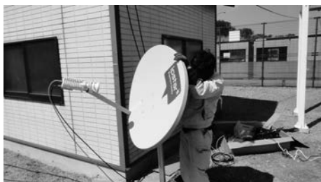
写真4 可搬型衛星通信システム
