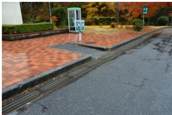
【NO. 6】 深谷 P A (下り)
