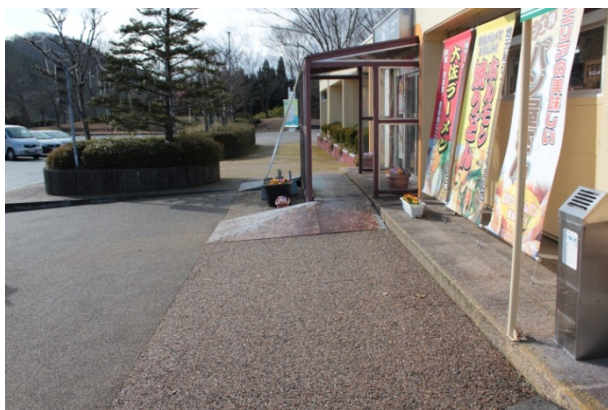
図表 2-(1)-⑨ 車いす使用者用駐車場の円滑な利用が難しいとみられるもの（2施設）
