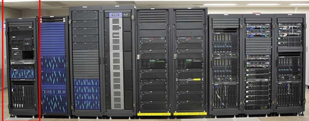
北九州市 システム基盤(フロントパネルを外した状態)
