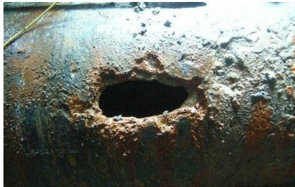
貫通箇所拡大
