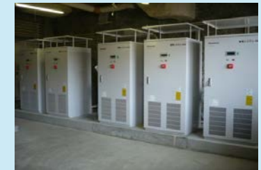
図2（蓄電池システム）
