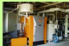
木質バイオマスボイラー
