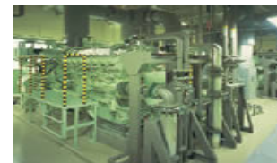
1,000kWクラス ガスエンジン発電設備
