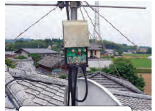
経年劣化したブースター
