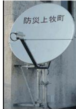
固定VSAT局 (市町村局 \phi 1.8m)
