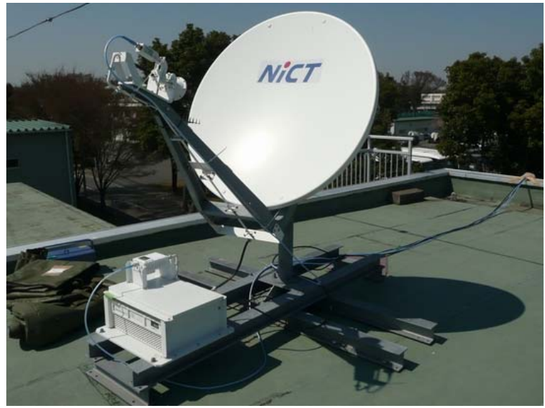
入間基地に設置した51M-VSAT
