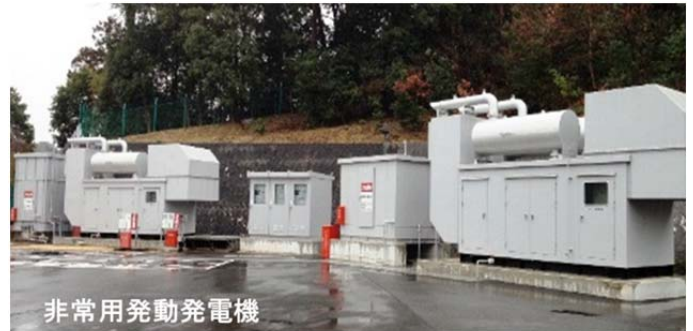
写真：衛星管制センターの非常用発電機の例
