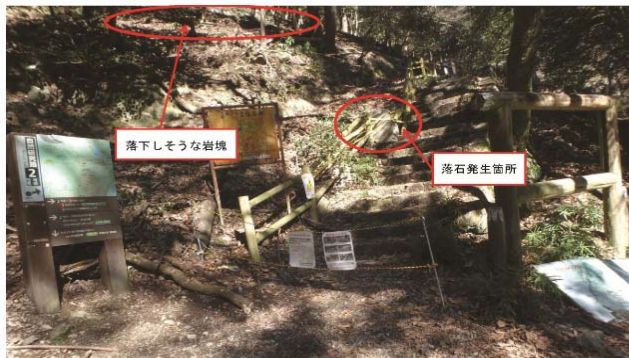
通行止め措置状況及び落石発生状況(百年橋側)
