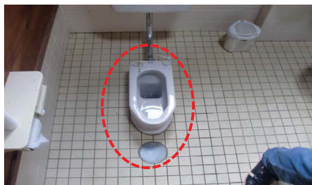
図表 2- (1) -10 現地での適切な情報提供の観点から改善を要する事例（誘導標識の未設置）
