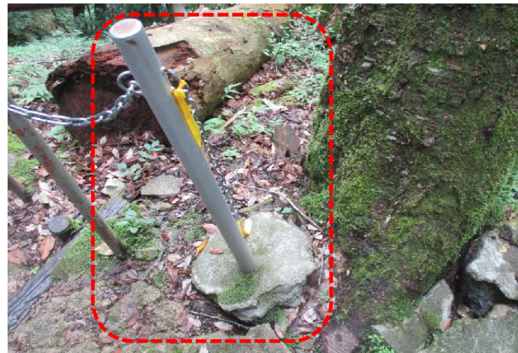
② 遊歩道の破損した安全柵(不動滝)
