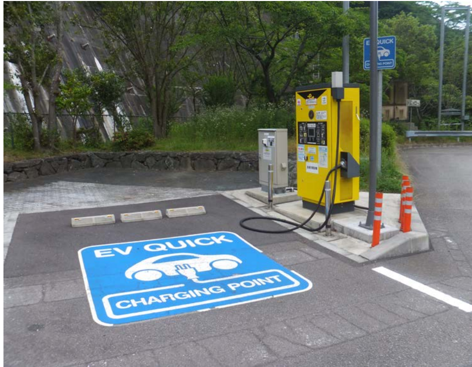
本体脇に小さく「近づかないで下さい」との注意喚起シールが貼られているが、目前まで近づかないと分からない状況となっている。
