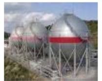
液体水素タンク
