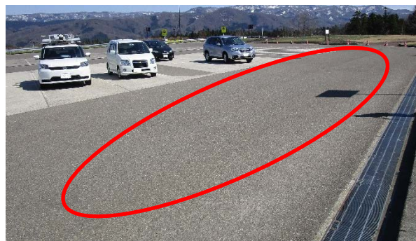
(妙高SA下り休憩施設内)
