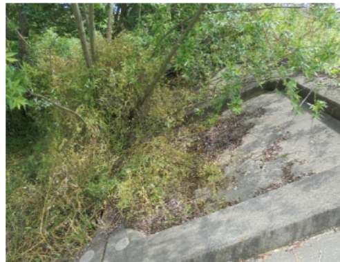
〈護岸に樹木が生えているもの〉
