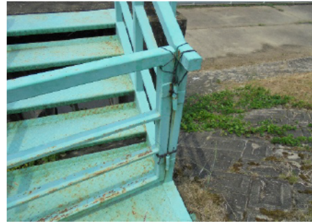
〈入口の開き戸が紐で仮止めされているもの〉
