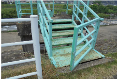
〈入口扉が施錠されていない〉
