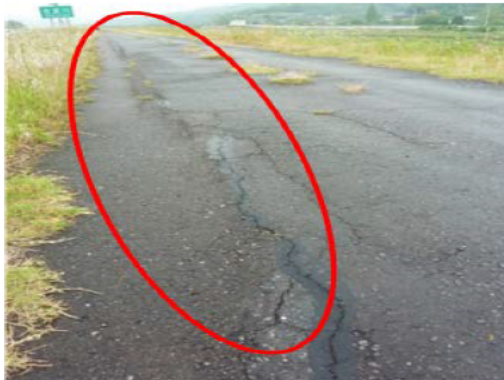
〈堤防に多数の亀裂やアスファルト舗装が剥がれているもの〉
