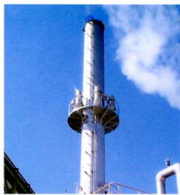
40t/hボイラー
