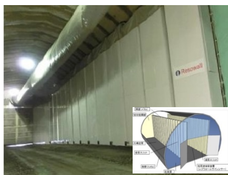
図-5 空間の共鳴を利用したトンネル発破時の低周波音低減（主に 16~63 Hz の発破音を吸音、低減） 7)
