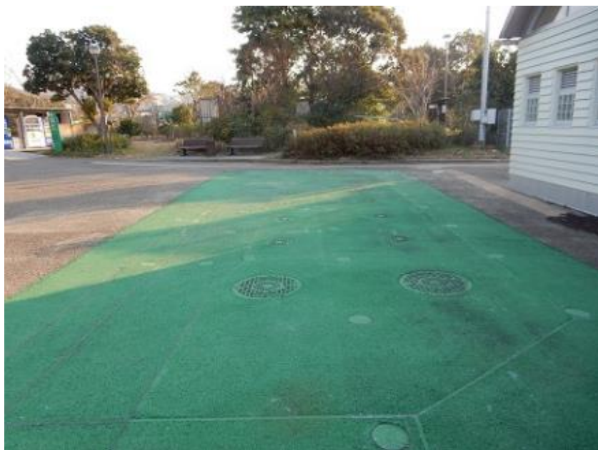
(マンホールトイレの貯留槽)
