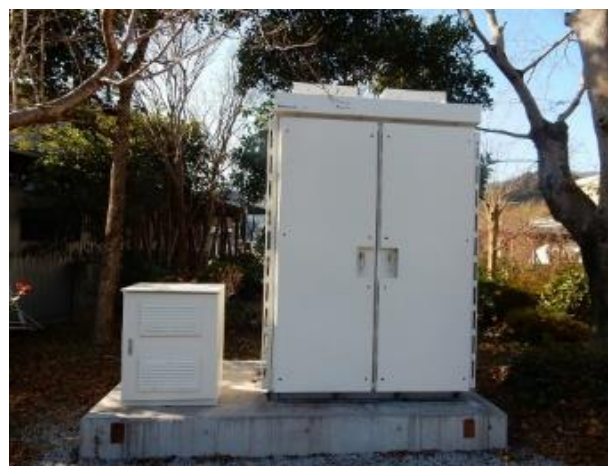
蓄電池（発電容量：20kW）
