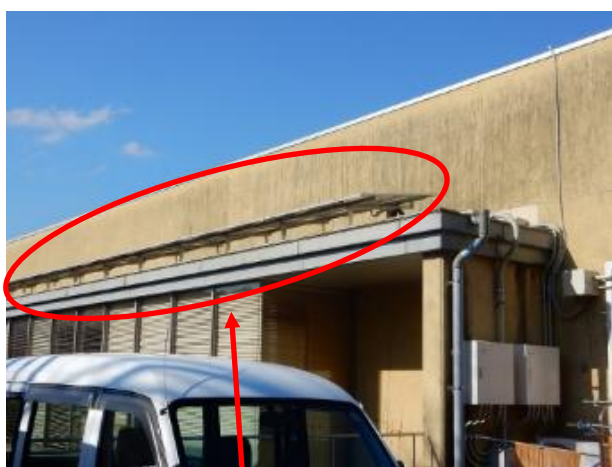
太陽光パネル（発電容量：15kW）
