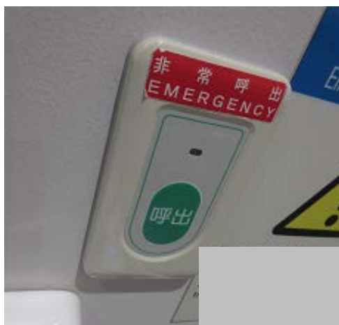
図表 2-⑨ トイレ個室内の呼出ボタンに点字表示がない例
