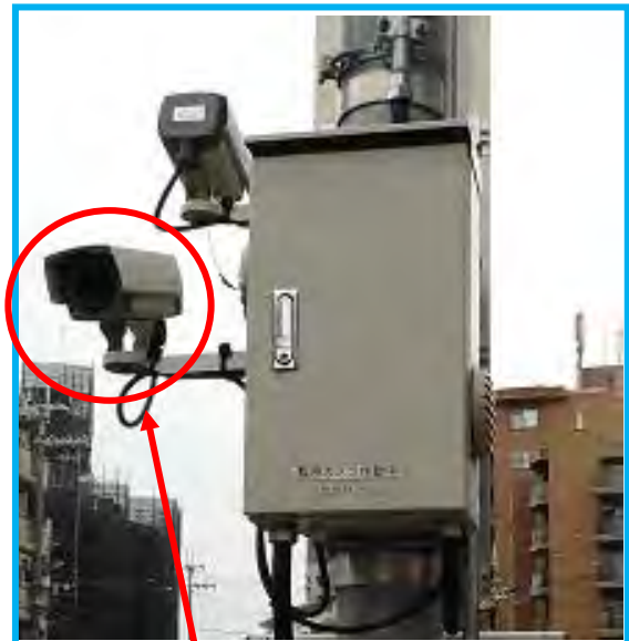
アンダーパス内部に向けられた監視カメラ (国道 423 号 北大阪急行電鉄 アンダーパス) なお、上部のカメラは、エア遮断機撮影用
