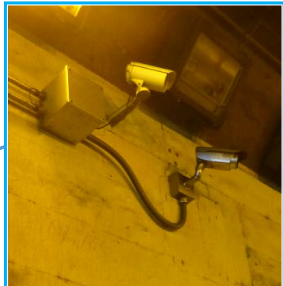
アンダーパス内部に設置された監視カメラ。堺市は、このカメラを通して冠水状況を監視
