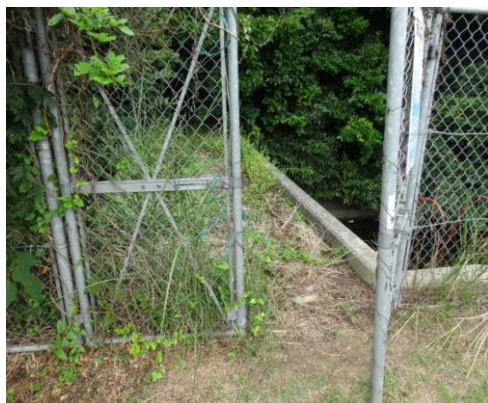
進入防止柵が未施錠
