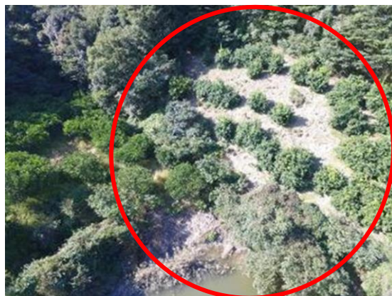
斜面の土砂崩壊とため池への土砂流入が発生
