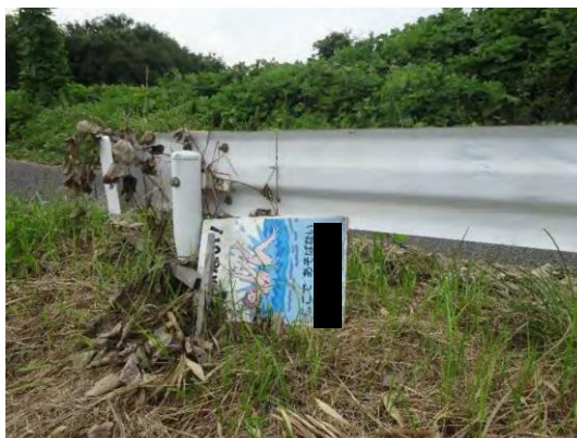
注意看板の損壊
