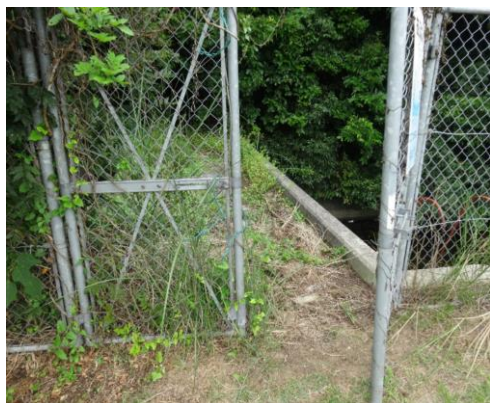
進入防止柵が未施錠
