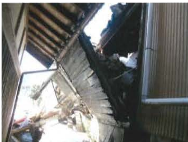
※外壁が隣家に接触している
