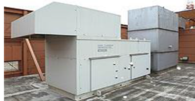
（非常用自家発電装置）
