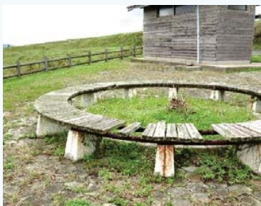
ベンチが破損
