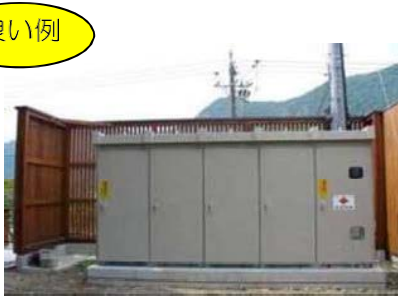
道の駅「美濃にわか茶屋」(岐阜県美濃市) 非常用の電源装置を設置
