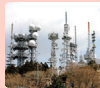
各種無線通信用鉄塔
