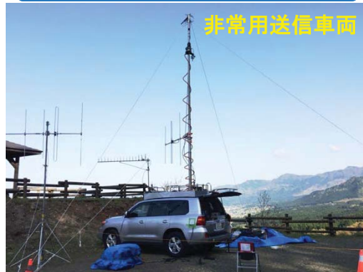
送信所のバックアップ設備
