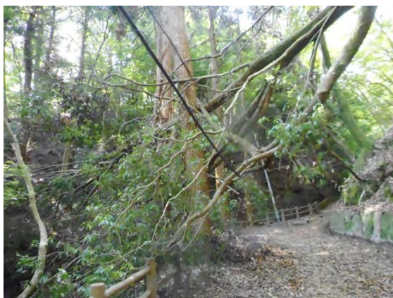
倒木が引っかかっている電線の状況
