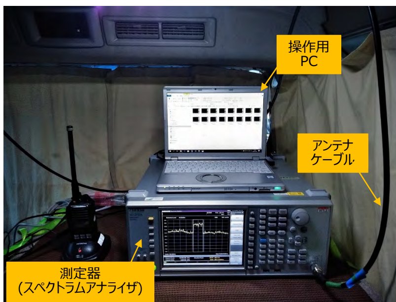
図 2-61 地上側の車両内に設置された無線設備（積雪期）
