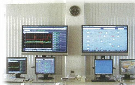
中央監視装置（市内全域の監視） ▶ 各施設の運転状況や送水量を常時監視
