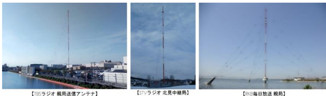
図表 29 AM ラジオ放送の送信設備
