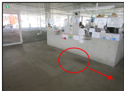
枠内で点字ブロックが途切れている。
