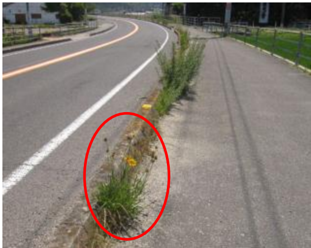
事例1 国道11号（Ed市町、平成25年6月当局撮影）
