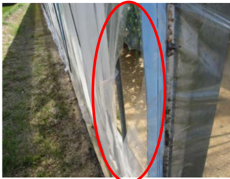
ビニールの破損
