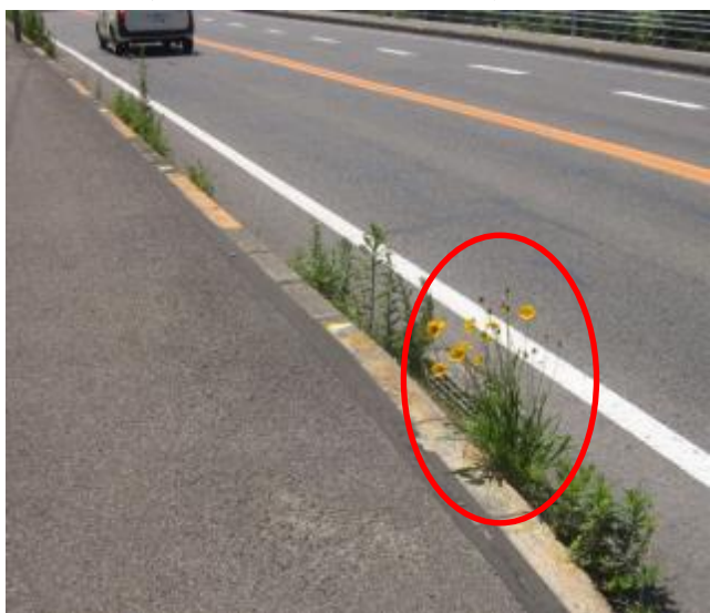
事例2 国道11号（Ec市町、平成25年6月当局撮影）
