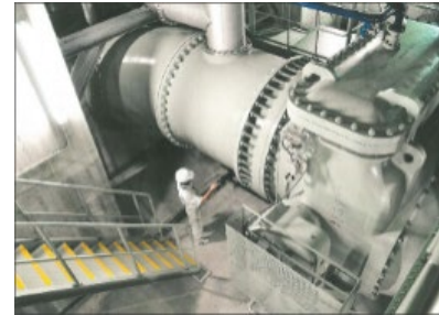
雨水ポンプの整備
